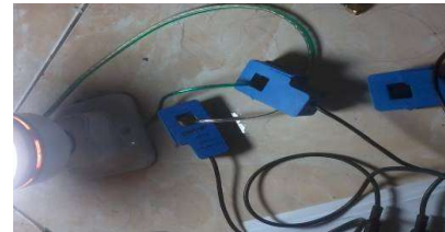
Gambar 4.5 Pengujian Dengan Kondisi Satu Sensor Arus Tidak Dikaitkan Pada Kabel
